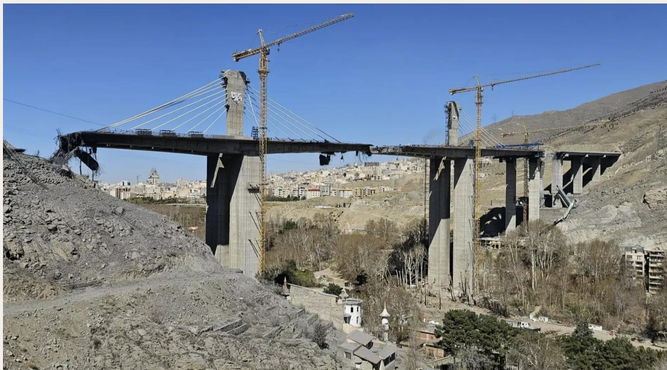
Разрушенный мост В-1 в Иране
